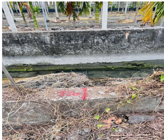
說明：圳路現況掏空嚴重
